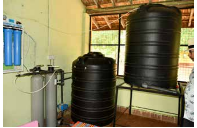
Le système de filtration avec la réserve d'eau
